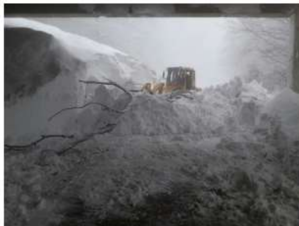
Figura 15 Macchina operatrice impegnata a liberare il passaggio lungo la SP 106
